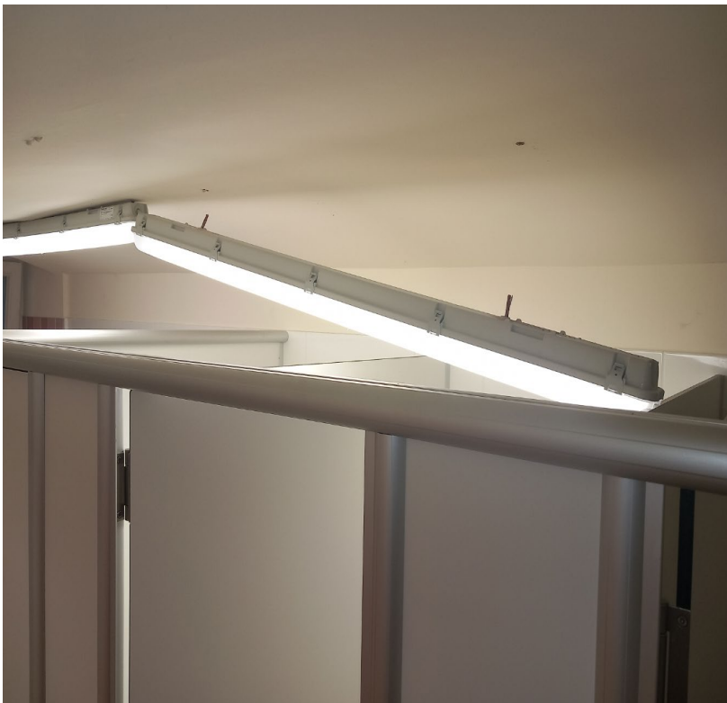
Marienstr. 64 – 17.04.2026 – abgerissene Lichtleiste in WC-Anlage
