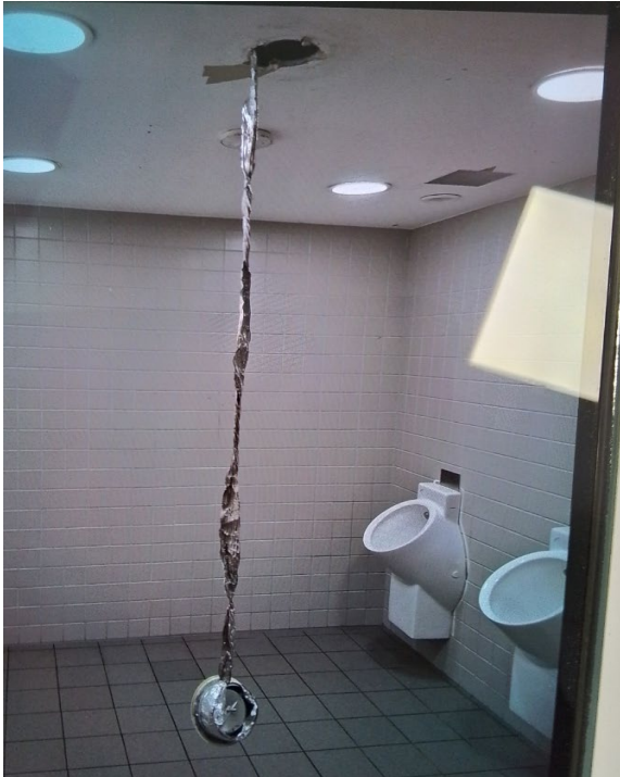
Nocken 21.04.26 – herausgerissene Deckenlampe
